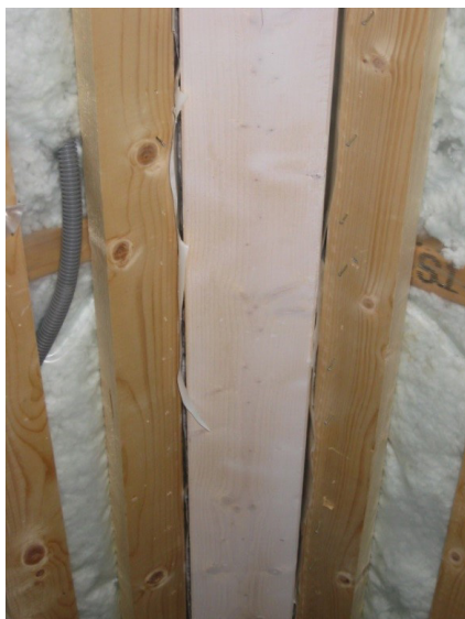
Plastfolien avslutad på vardera sidan om balken i nock. Luften passerar igenom glipor.
