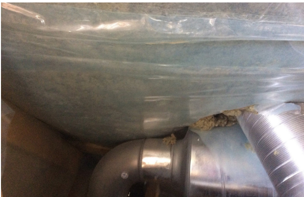
Otäthet mellan ventilationsrör och plastfolie.
