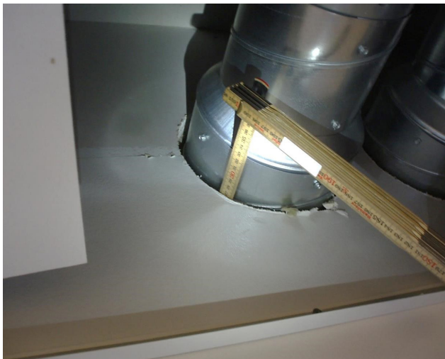
Fig 22 Håltagning för ventilationskanal utförd genom färdig väggkonstruktion. I detta fall kommer man ej åt att tätta mellan röret och väggens plastfolie som ligger 45 mm ut i konstruktionen, man kommer enbart åt att tätta mellan kanal och inre skiva (vilket man dock heller ej gjort i detta fall, detta skulle föreställa färdigställt).
