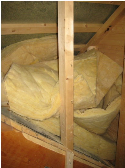
Överbliven isolering intryckt i sidovind.
