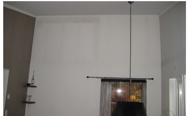
Sot i inomhusluften har fastnat på målad väggyta. Isolerbristerna framträder tydligt.
